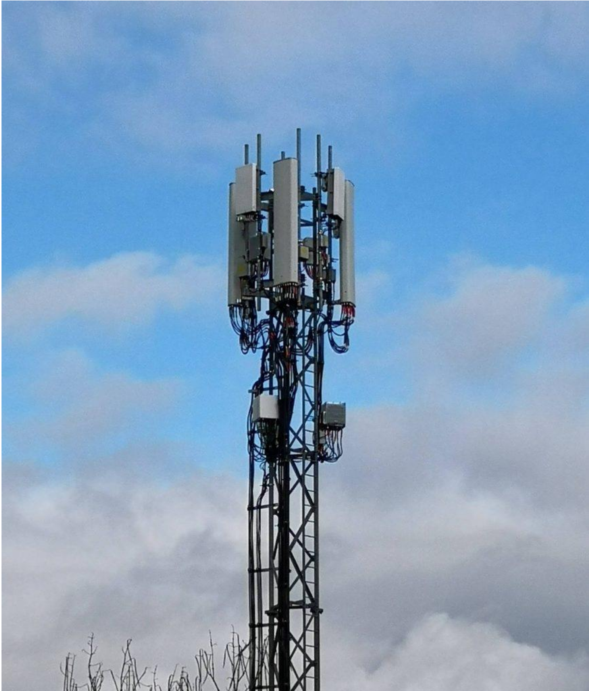
Slika 5.2. Izgled WiMAX tornja [9]
