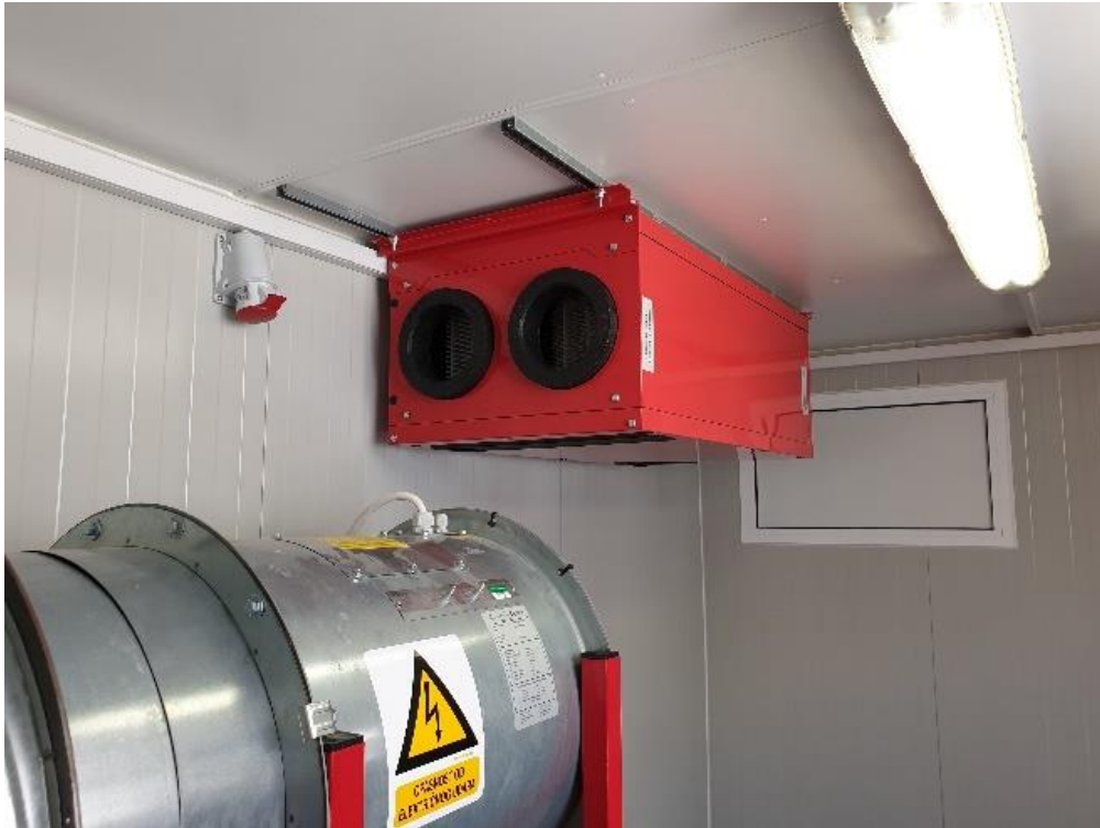
Slika 4.3 - Uređaj postavljen na strop [13]
