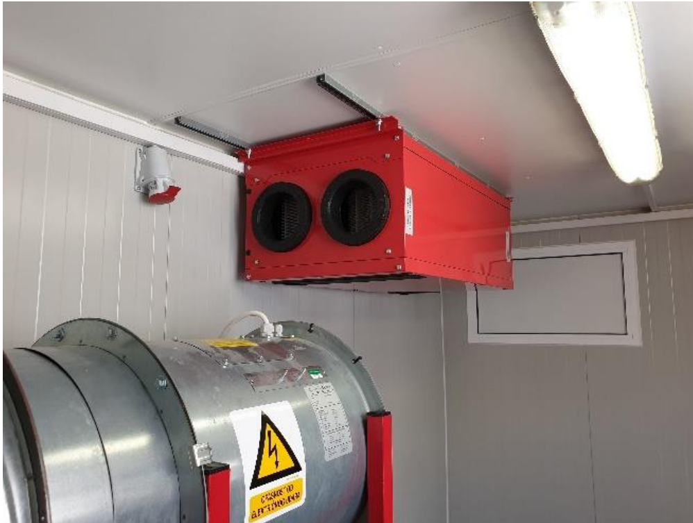
Slika 4.3 - Uređaj postavljen na strop [13]
