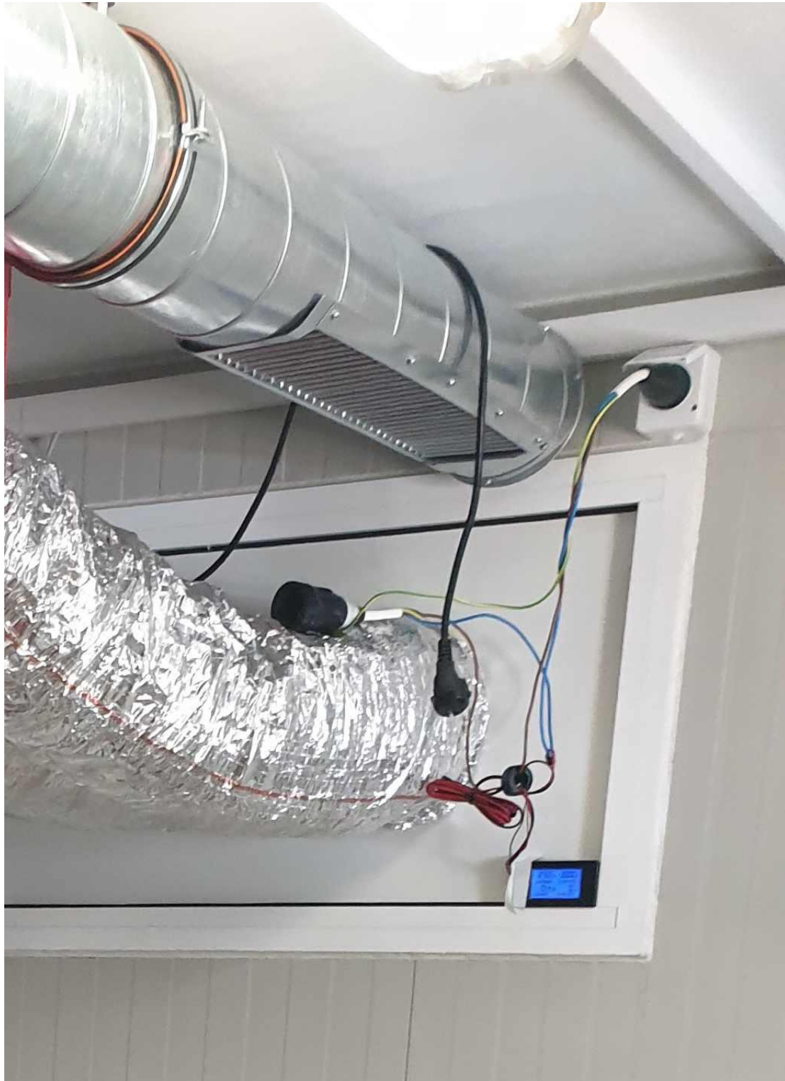
Slika 5.3 - Postavljeno digitalno mjerilo potrošnje el. energije [13]
