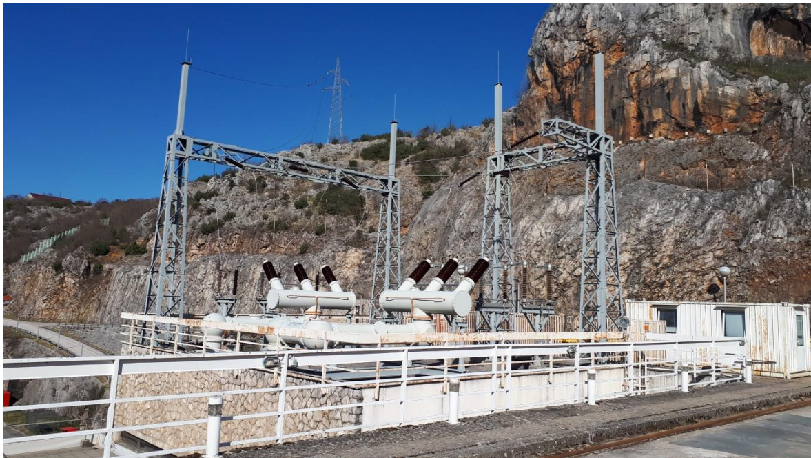
Slika 3. 4. Postrojenje i dalekovod 110 kV HE Đale [15]
