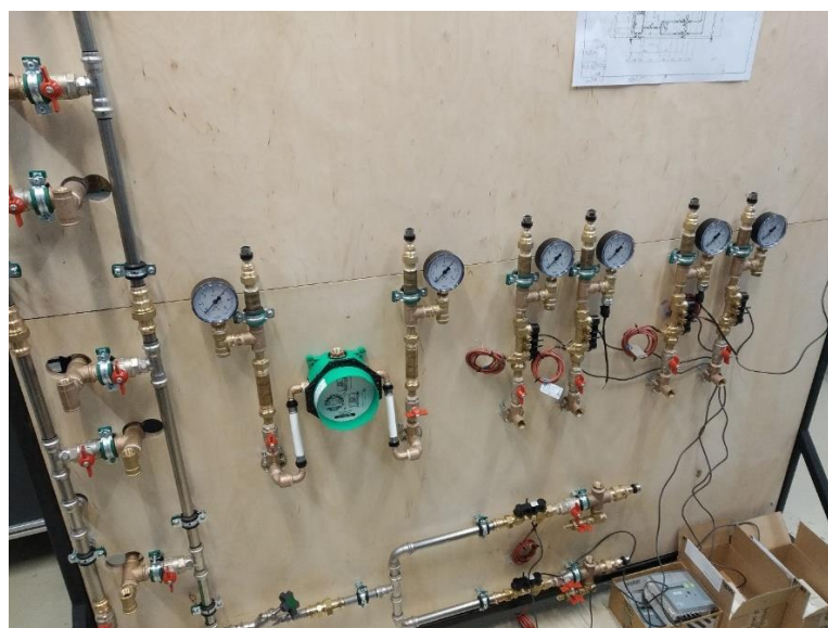
Slika 5.35 - Stalni dio cjevovoda sa ugrađenim mjernim elementima
