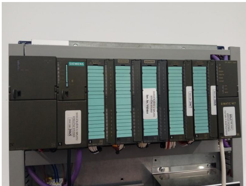
Slika 3.1 Izgled PLC stanice
