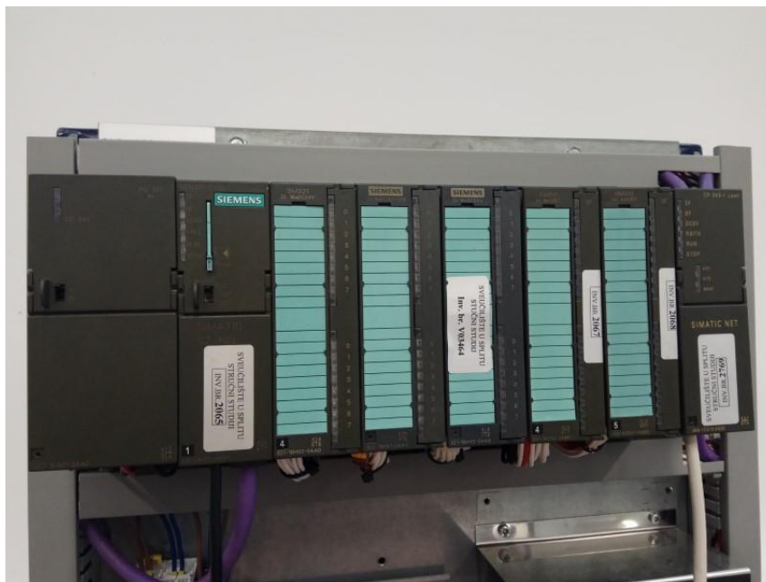
Slika 3.1 Izgled PLC stanice
