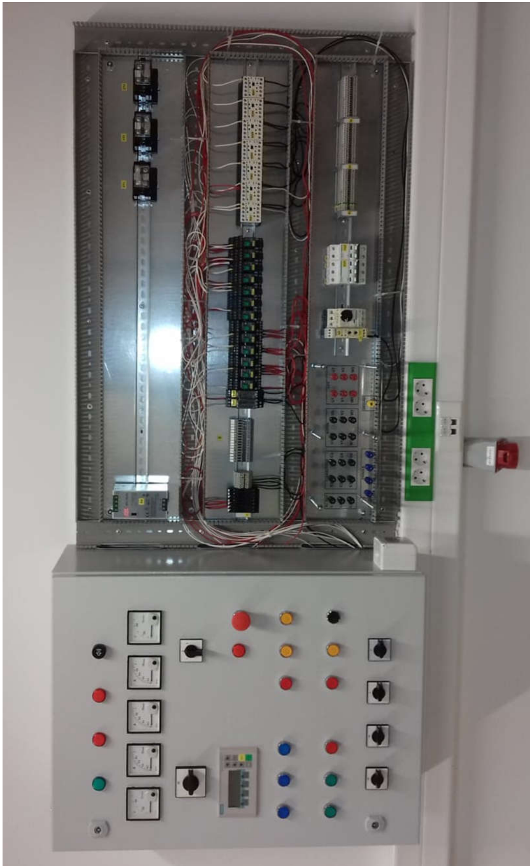
Slika 5.12. Upravljačka ploča i ormar
