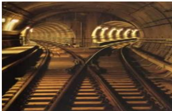
Slika 8. Korozija lutajuće struje u tunelu [9]
