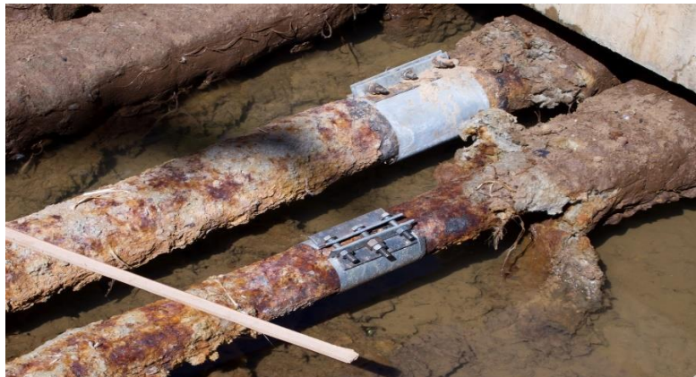
Slika 2. Korozija u tlu [3]
