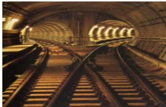
Slika 8. Korozija lutajuće struje u tunelu [9]
