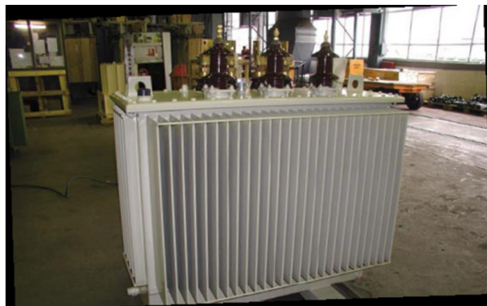
Slika 2. 5: VE ORLICE - transformator vlastite potrošnje (tzv. kućni transformator – KT)
