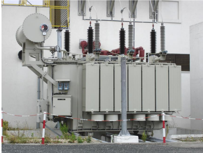
Slika 2. 6: Transformator 110/10 kV, 68,5 tona, 15 tona ulja
