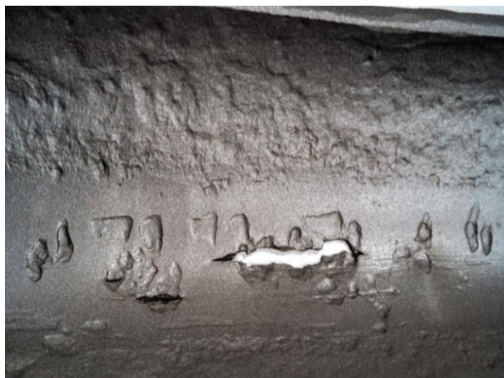
Slika 4.5 Primjer rupičaste korozije cjevovoda [12]
