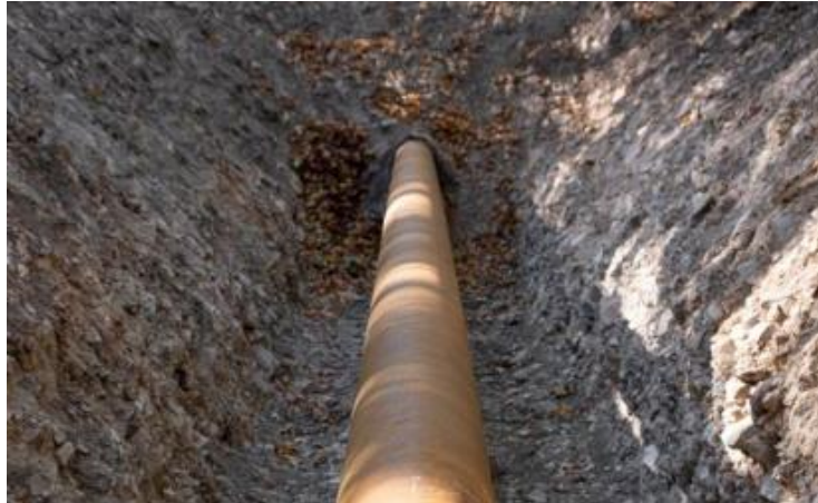
Slika 4.4 Opća korozija ukopane čelične cijevi[9]
