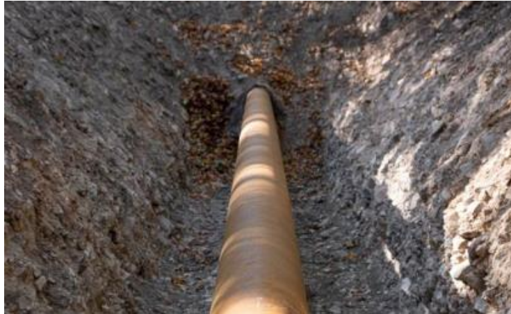
Slika 4.4 Opća korozija ukopane čelične cijevi[9]
