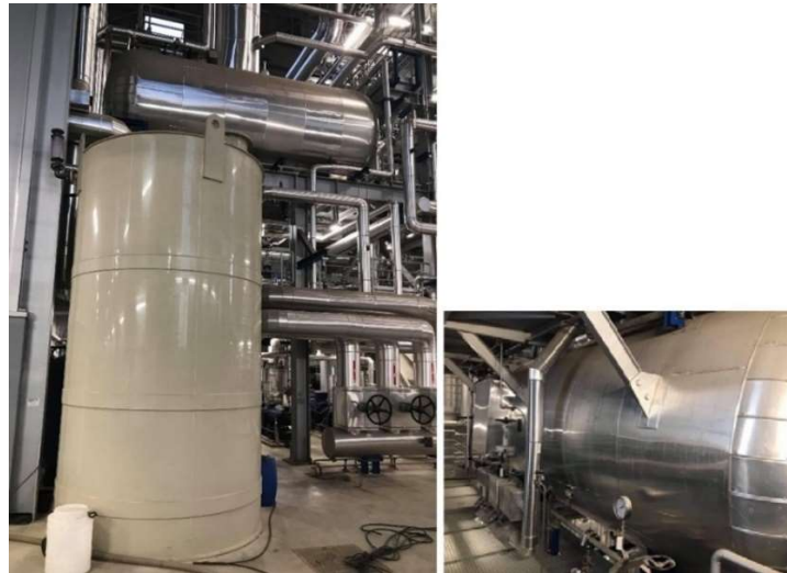
Slika 4.2. Spremnici za vodu
