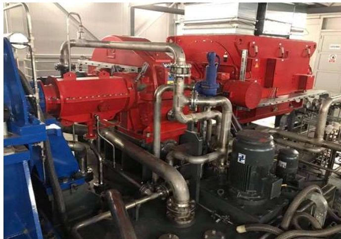
Slika 4.4. Generator i reduktor
