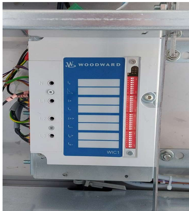
Slika 5.3. WIC1 – relej ugrađen u TS Duboka [37]
