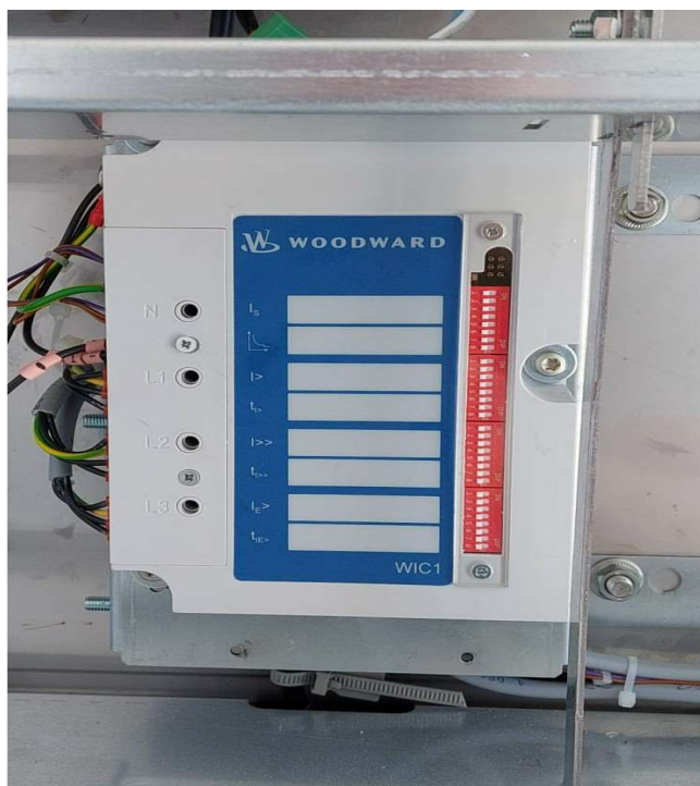
Slika 5.3. WIC1 – relej ugrađen u TS Duboka [37]
