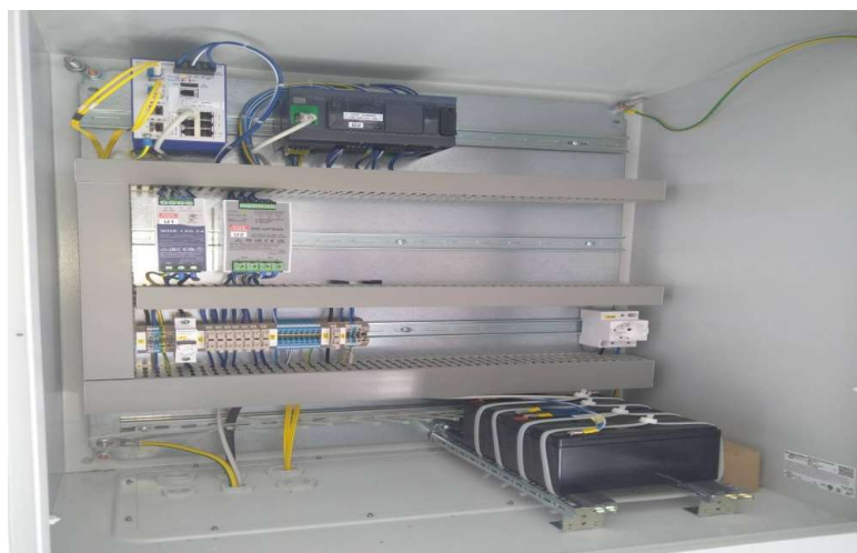
Slika 6.3. Daljinska stanica - komunikacijski ormar u TS Duboka [37]
