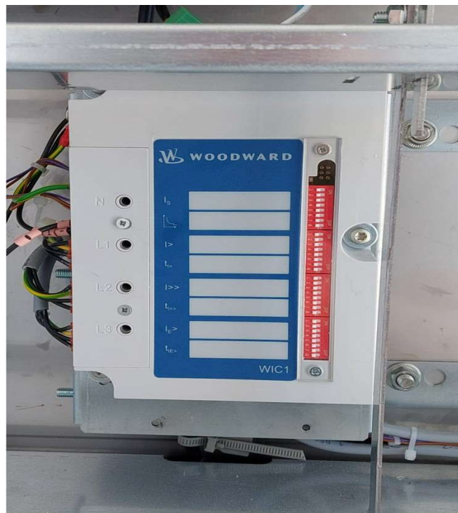
Slika 5.3. WIC1 – relej ugrađen u TS Duboka [37]
