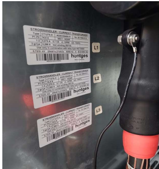
Slika 5.4. Natpisne pločice strujnih transformatora unutar SN bloka TS Duboka [37]
