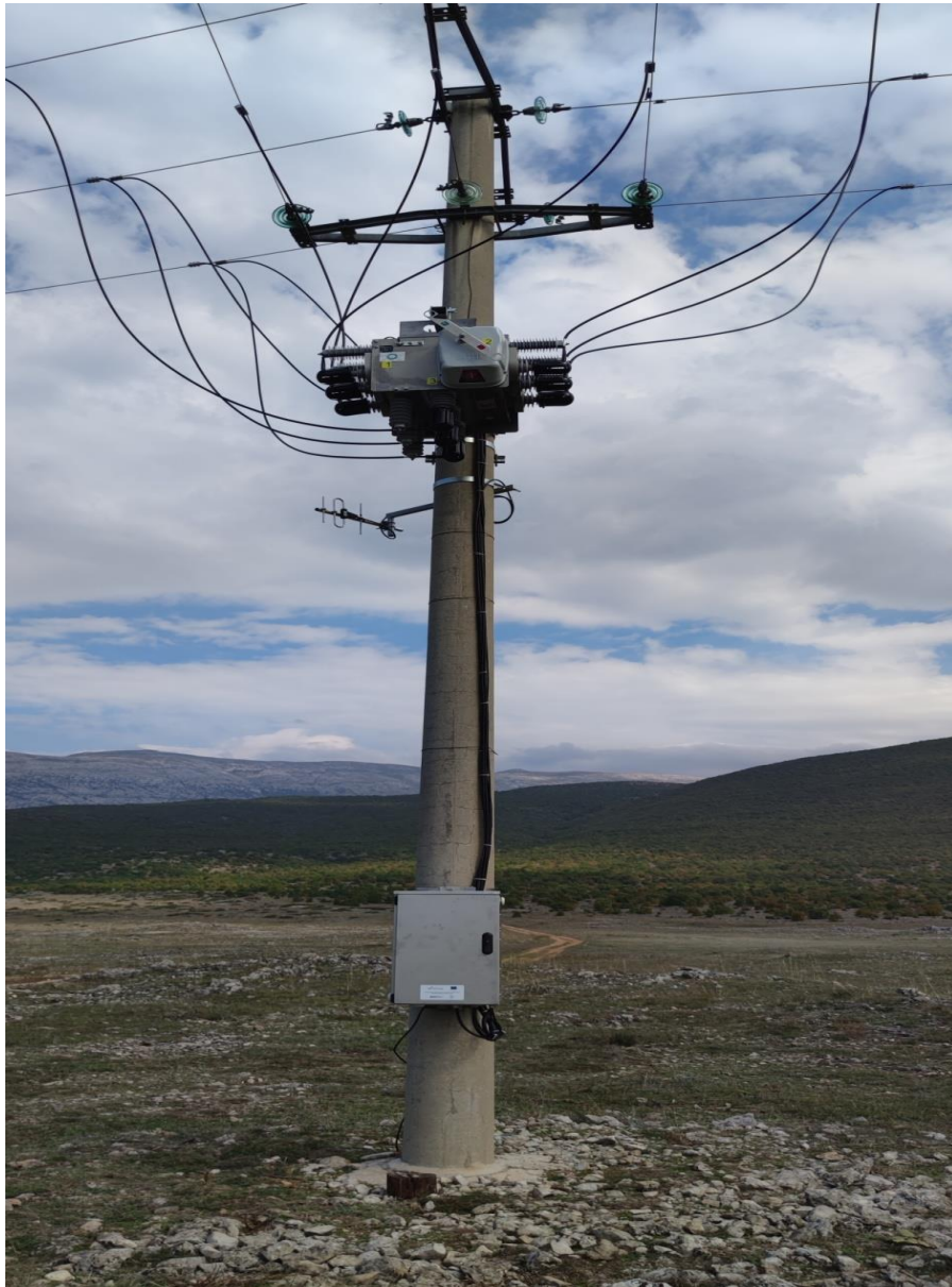
Slika 10. Stup srednjeg napona sa ugrađenom automatizacijskom opremom [TJ Sinj]
