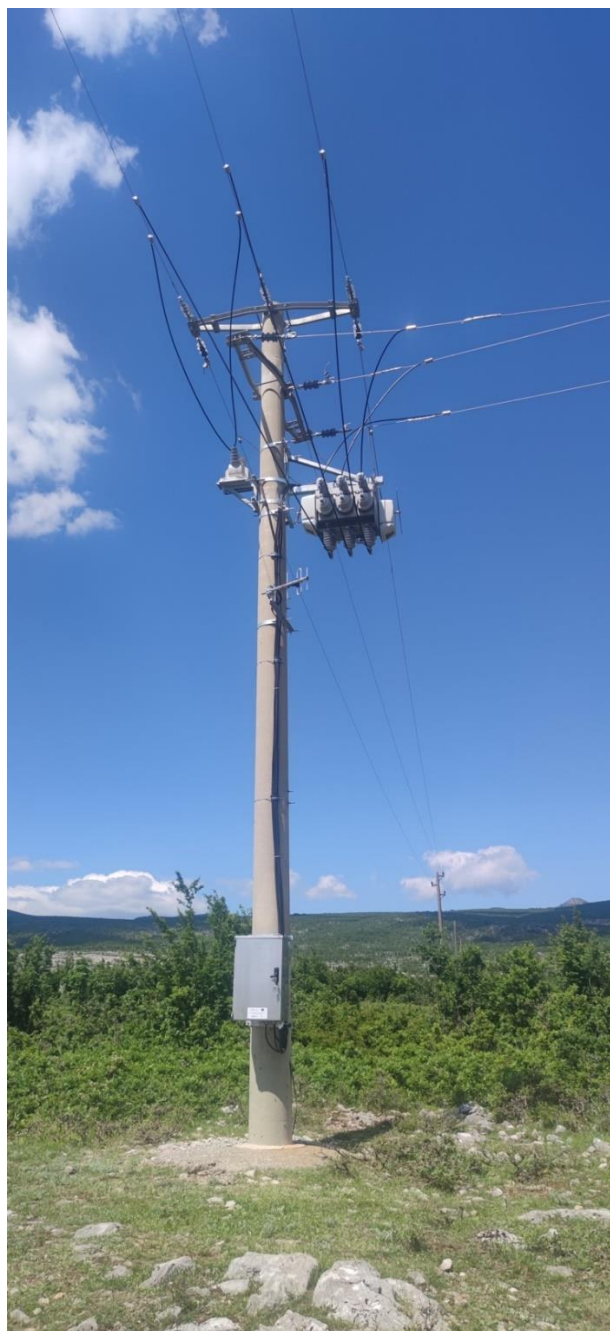
Slika 3.19. Stup sa ugrađenim DURN-om [TJ Sinj]
