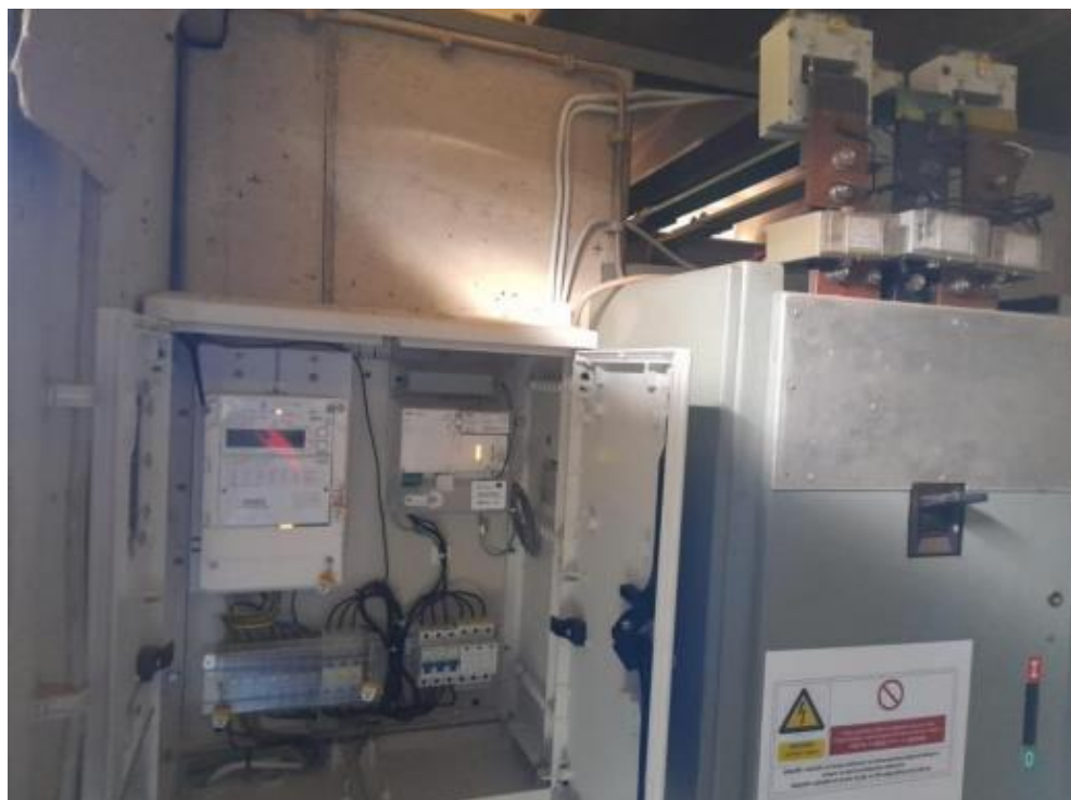
Slika 3.21. Sumarno brojilo unutar TS 10(20)/0.4 kV [11]
