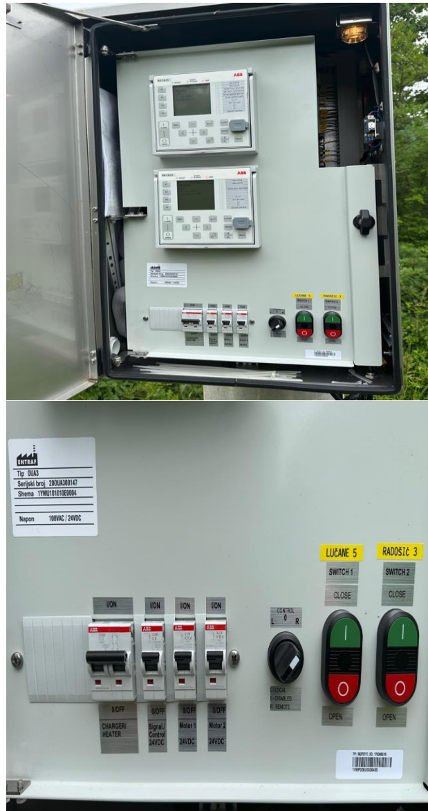
Slika 5.35. Elementi unutar upravljačkog ormara [TJ Sinj]
