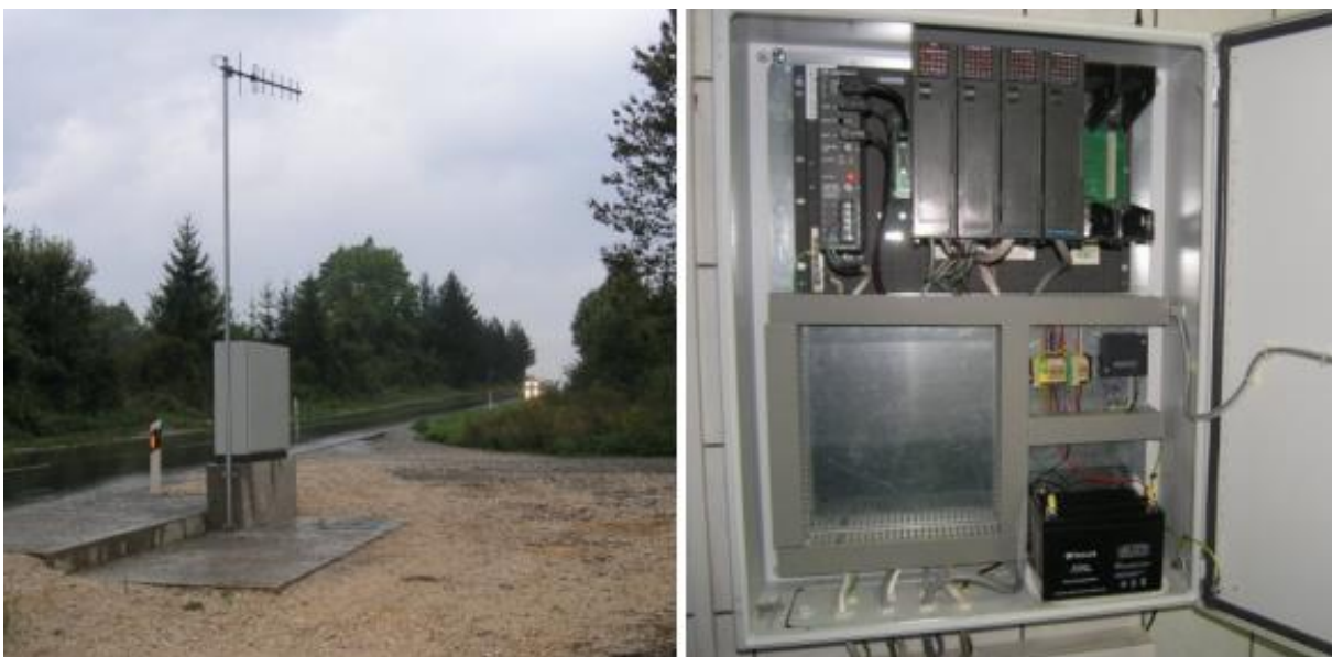
Slika 3.23. RTU ormar i oprema unutar ormara [9]
