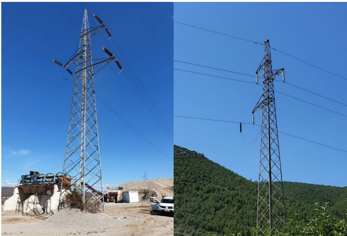
Slika 2.4. Zatezni i nosivi stup nadzemnog voda
