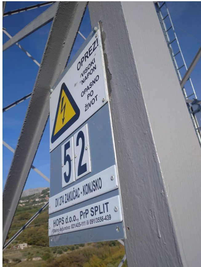
Slika 5.10. Tablica za označavanje dalekovoda
