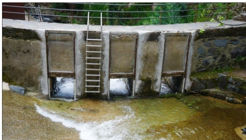
Slika 8.3– Otvori za kontrolu protoka vode
