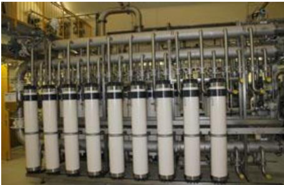
Slika 4.6 - Sustav za prečišćavanje vode pomoću tehnologije ultrafiltracije [10]
