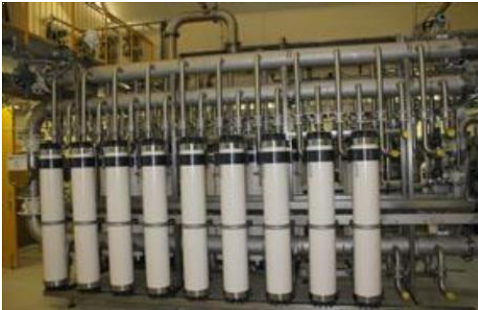
Slika 4.6 - Sustav za prečišćavanje vode pomoću tehnologije ultrafiltracije [10]
