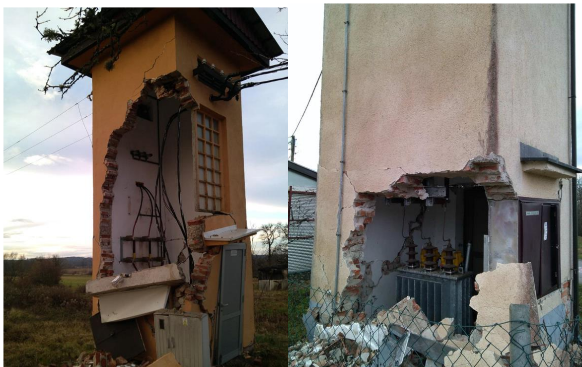
Slika 23. Oštećenja TS tipa 'toranj'
