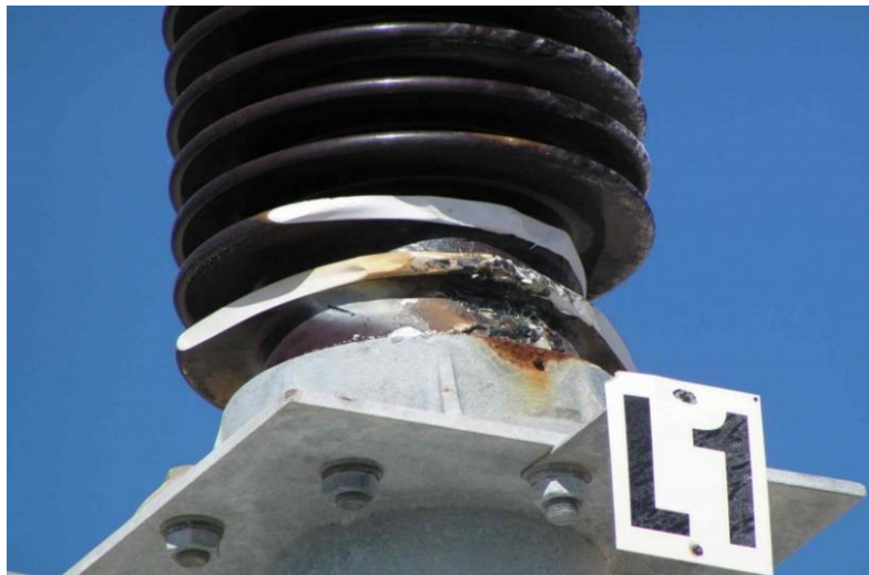
Slika 12. Oštećenje potpornog izolatora zbog kratkog spoja
