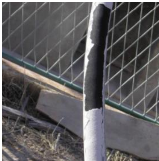
Slika 11. Naslage soli na kabelu
