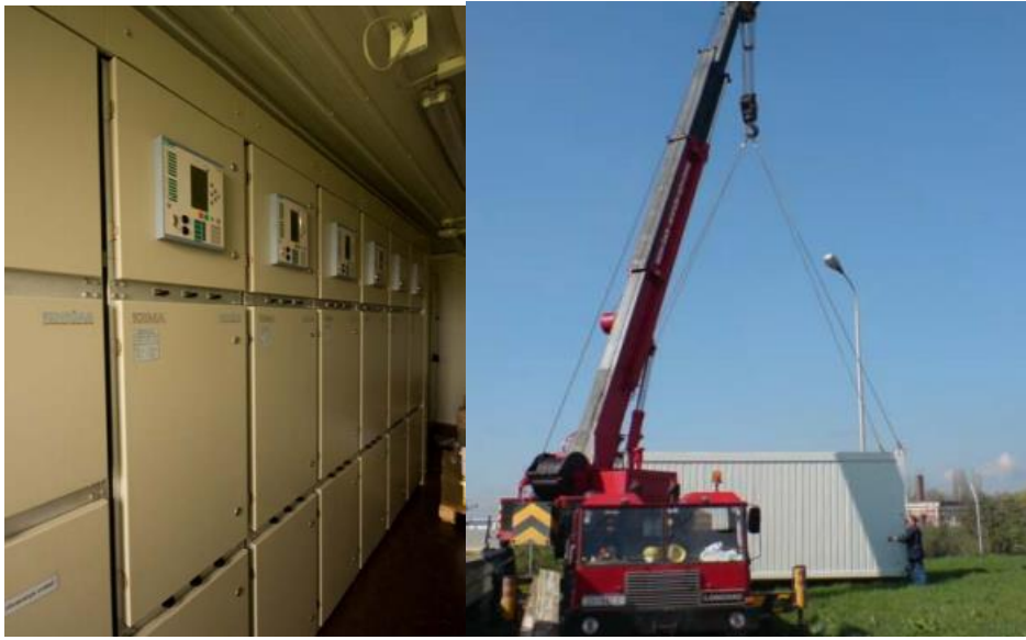
Slika 21. Istovar i unutrašnjost kontejnera sa SN opremom
