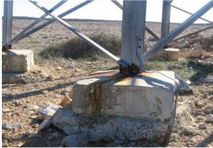
Slika 13. Korozija stupa dalekovoda
