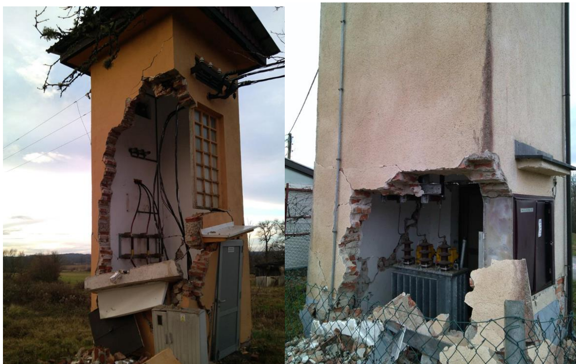
Slika 23. Oštećenja TS tipa 'toranj'
