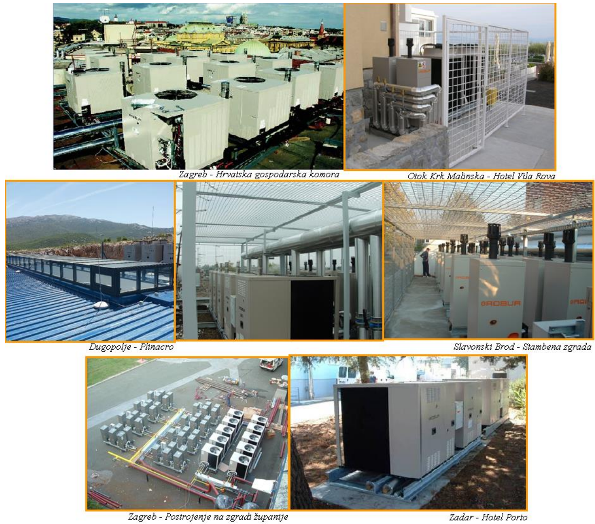
Slika 4.3 - Primjeri ugradnje apsorpcijskih plinskih dizalica topline u hrvatskoj [7]
