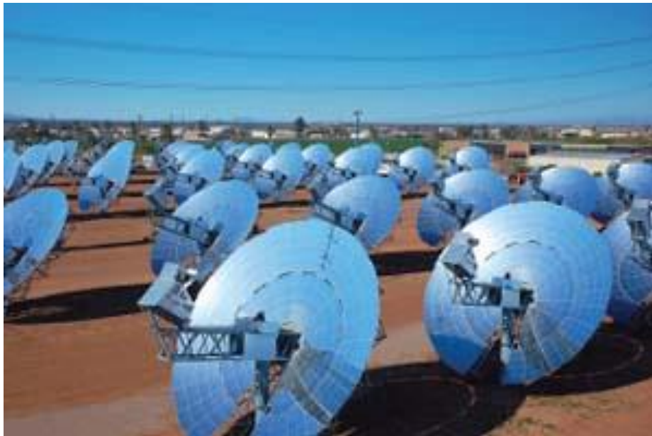
Slika 2.5. – Solarna elektrana Maricopa, Arizona [2]
