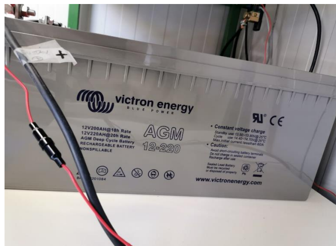
Slika 3.6 - Victron Energy AGM baterija 12V 220 Ah
