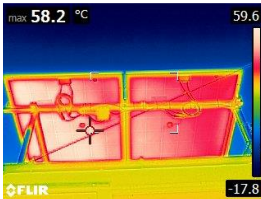
Slika 4.2 – Trenutačna temperatura solarnog panela slikano sa termalnom kamerom
