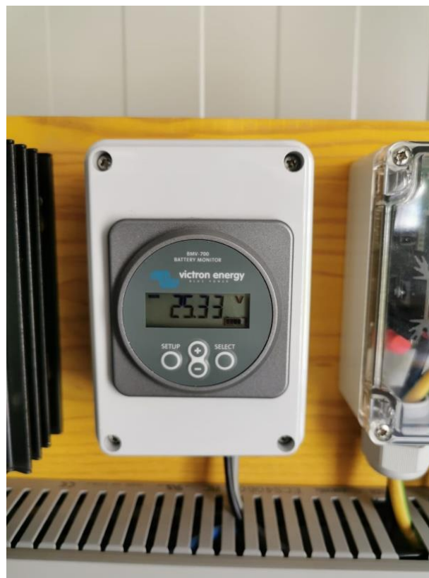
Slika 3.15 - Nadzornik baterije BMV 700
