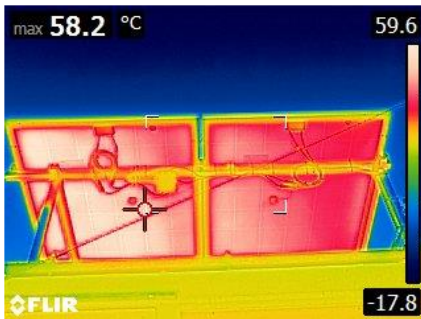
Slika 4.2 – Trenutačna temperatura solarnog panela slikano sa termalnom kamerom
