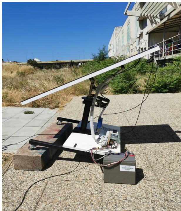
Slika 3.9 - Prikaz 12V/60Ah AGM baterije spojene na CdTe tehnologiju
