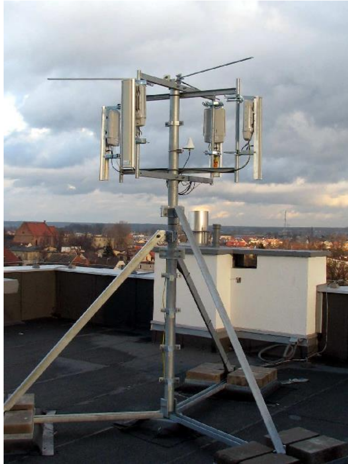
Slika 5.1. Izgled WiMAX bazne stanice na stambenoj zgradi [8]
