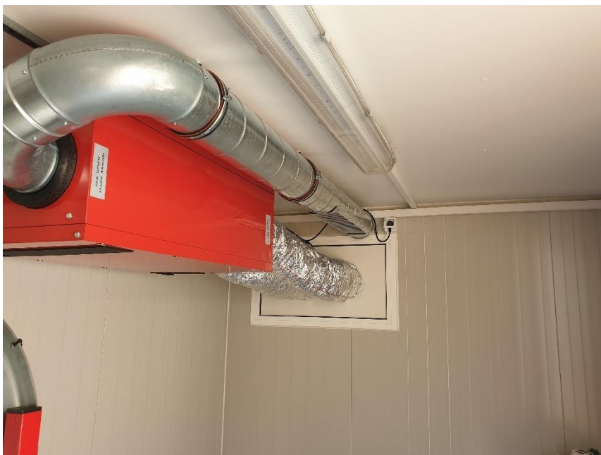
Slika 4.19 - Postavljena utičnica i uređaj spojen na napajanje [13]
