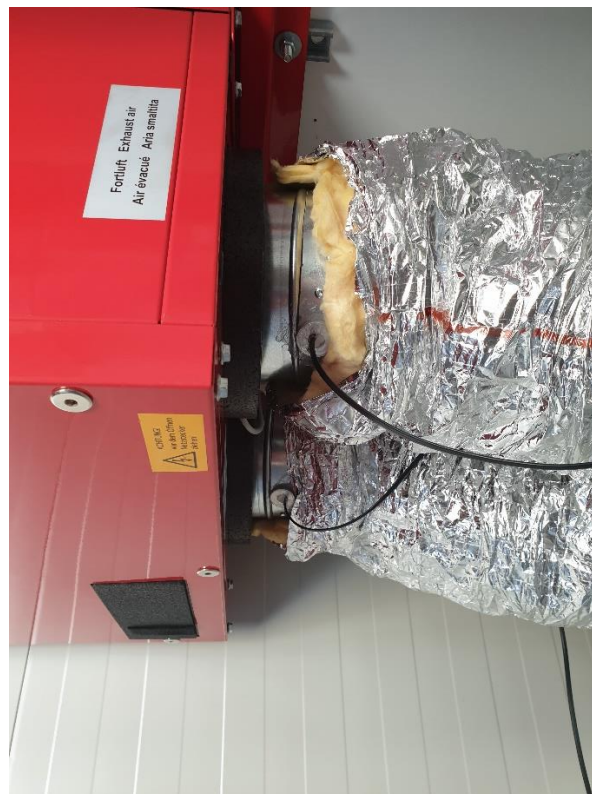
Slika 4.17 - Postavljeni osjetnici na kanale svježeg i otpadnog zraka [13]
