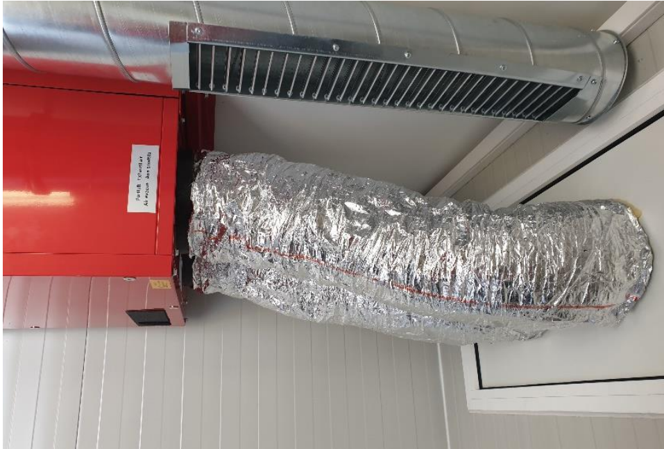
Slika 4.14 - Postavljene fleksibilne cijevi [13]
