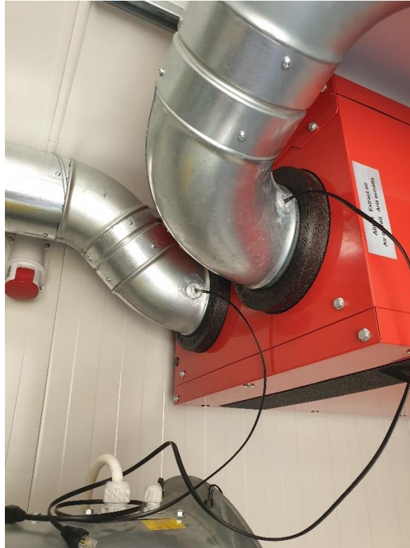
Slika 4.16 - Postavljeni osjetnici na kanalima dovoda i odvoda zraka [13]
