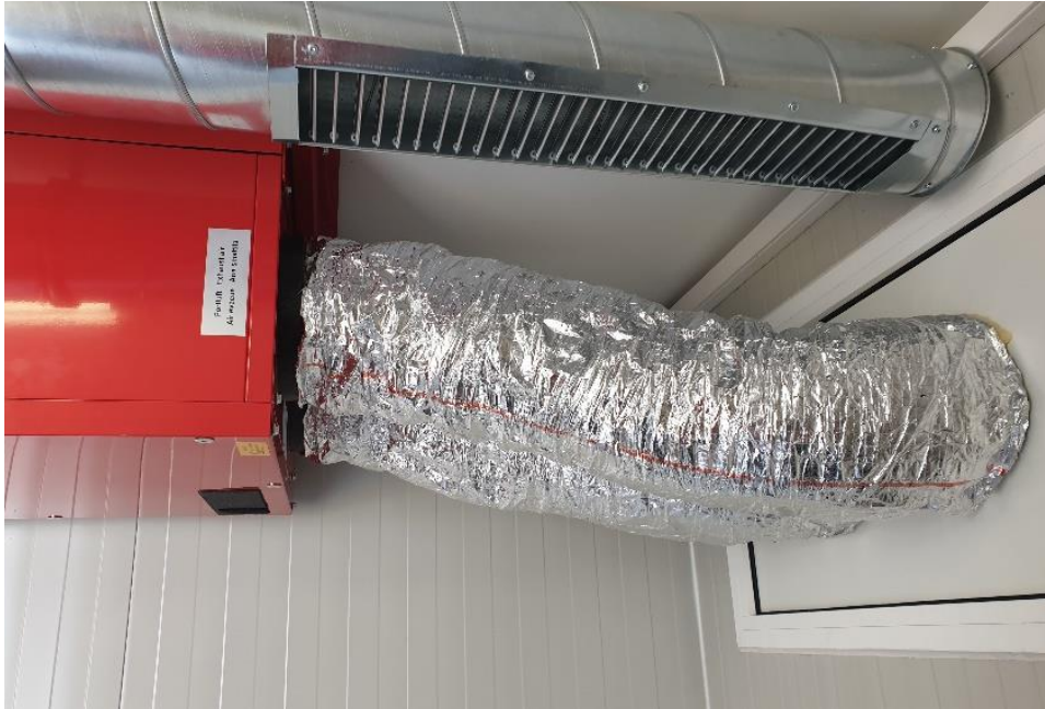
Slika 4.14 - Postavljene fleksibilne cijevi [13]
