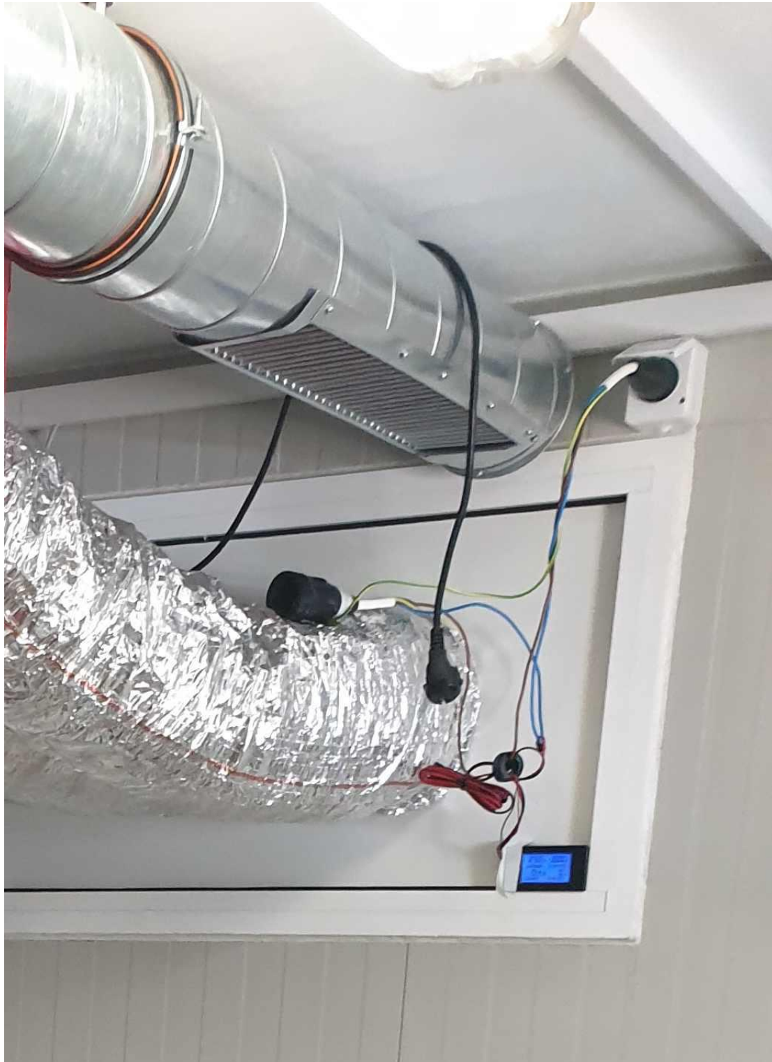
Slika 5.3 - Postavljeno digitalno mjerilo potrošnje el. energije [13]
