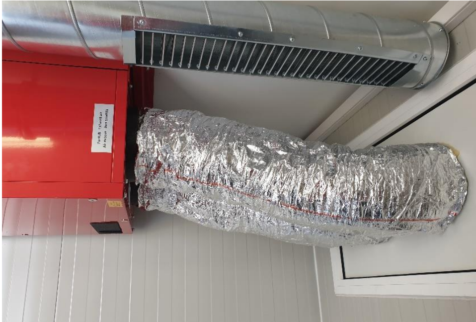
Slika 4.14 - Postavljene fleksibilne cijevi [13]
