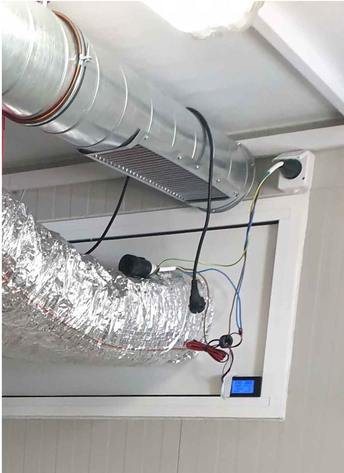
Slika 5.3 - Postavljeno digitalno mjerilo potrošnje el. energije [13]
