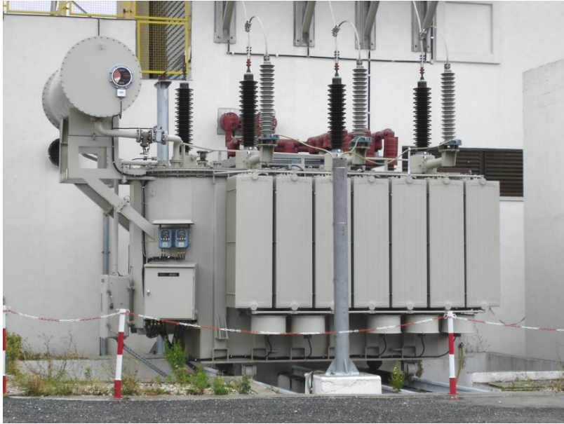
Slika 2. 6: Transformator 110/10 kV, 68,5 tona, 15 tona ulja
