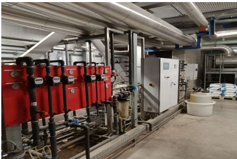
Slika 3.3. Dio postrojenja za kemijsku pripremu vode
