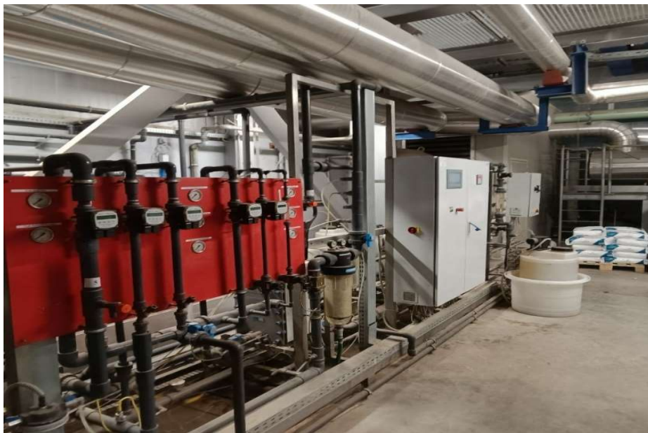
Slika 3.3. Dio postrojenja za kemijsku pripremu vode
