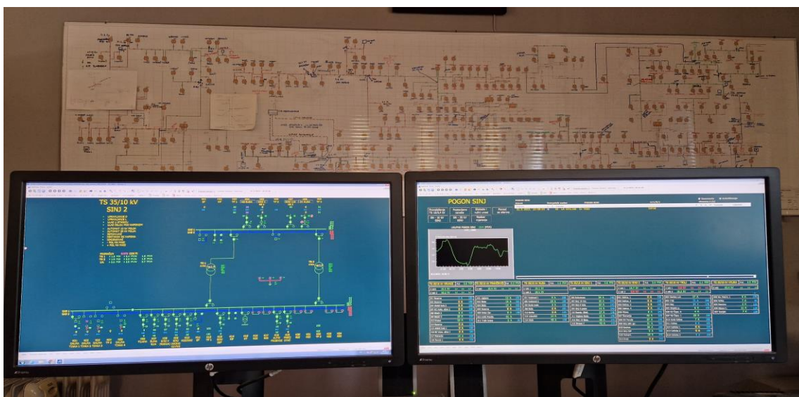
Slika 7. Aplikacija WS 500 za pristup SCADA sustavu – [TJ Sinj]
