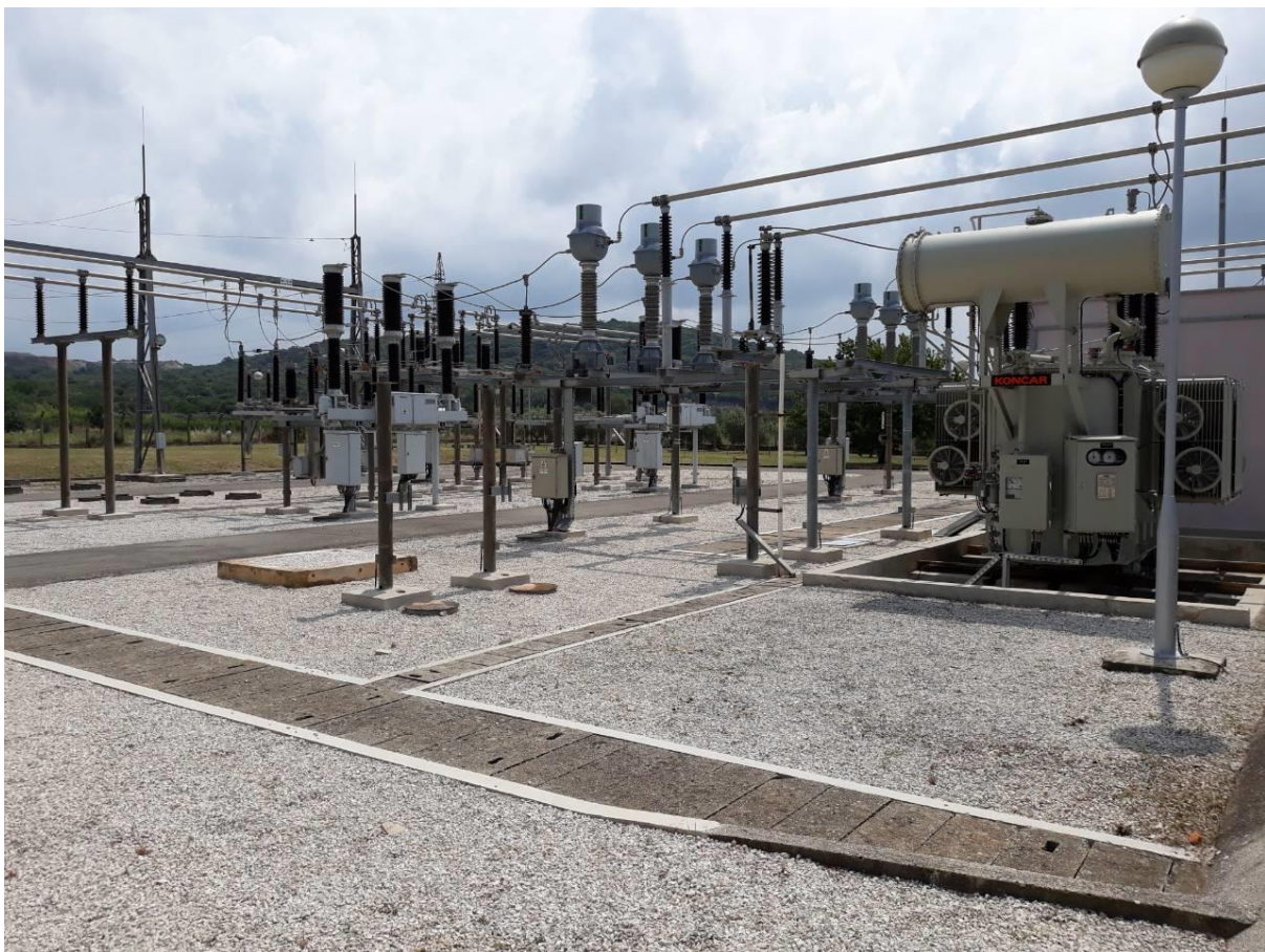
Slika 3. Trafostanica 110/20 kV – HEP ODS d.o.o.
