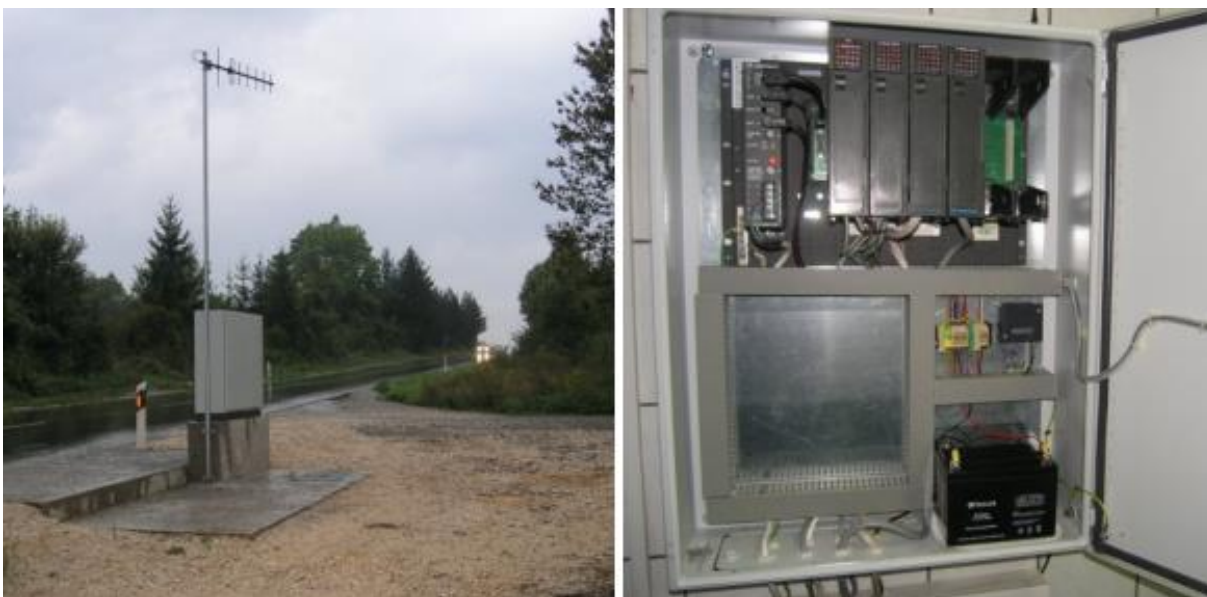
Slika 3.23. RTU ormar i oprema unutar ormara [9]
