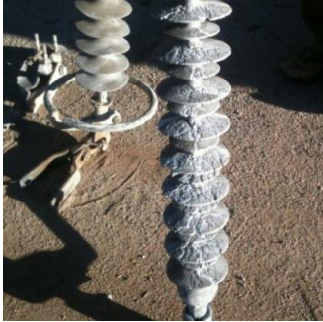
Slika 10. Naslage soli na izolatoru
