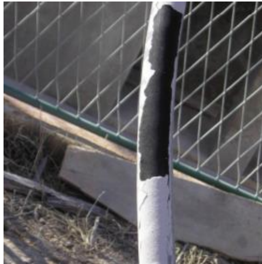
Slika 11. Naslage soli na kabelu
