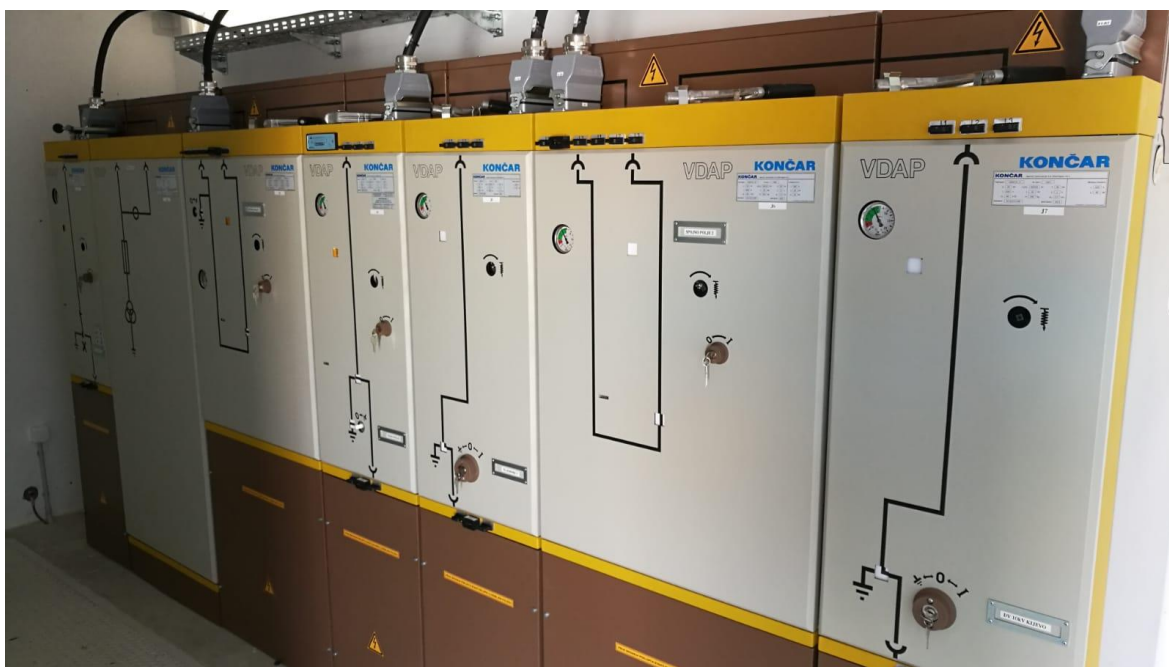
Slika 3.16. Srednjenaponski sklopni blok
