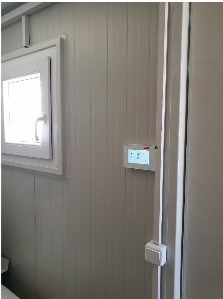
Slika 4.20 - Postavljen upravljač uređaja [13]
