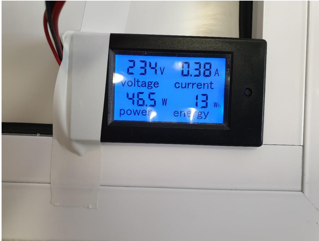
Slika 5.6 - Prikaz potrošnje el. energije nakon prvog probnog mjerenja [13]
