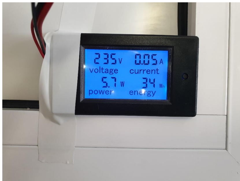
Slika 5.15 - Prikaz završnog stanja potrošnje brojila el. energije [13]
