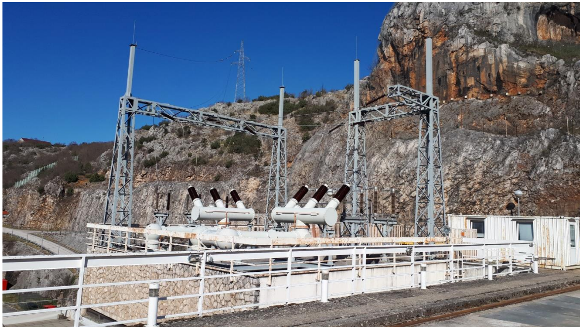
Slika 3. 4. Postrojenje i dalekovod 110 kV HE Đale [15]
