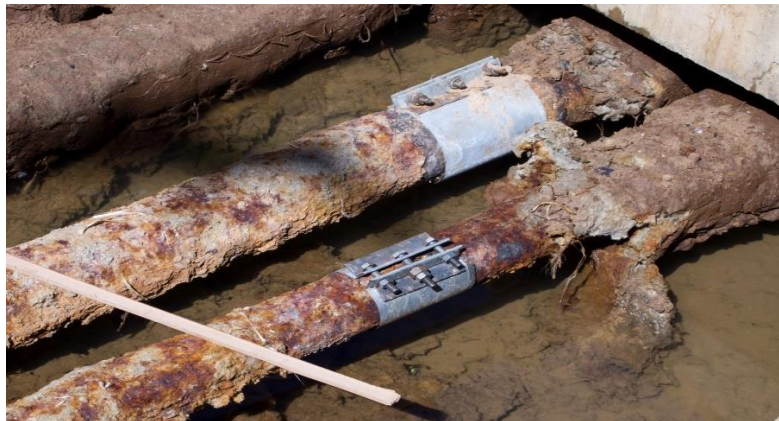
Slika 2. Korozija u tlu [3]
