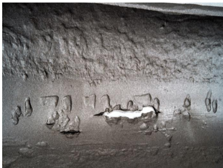
Slika 4.5 Primjer rupičaste korozije cjevovoda [12]
