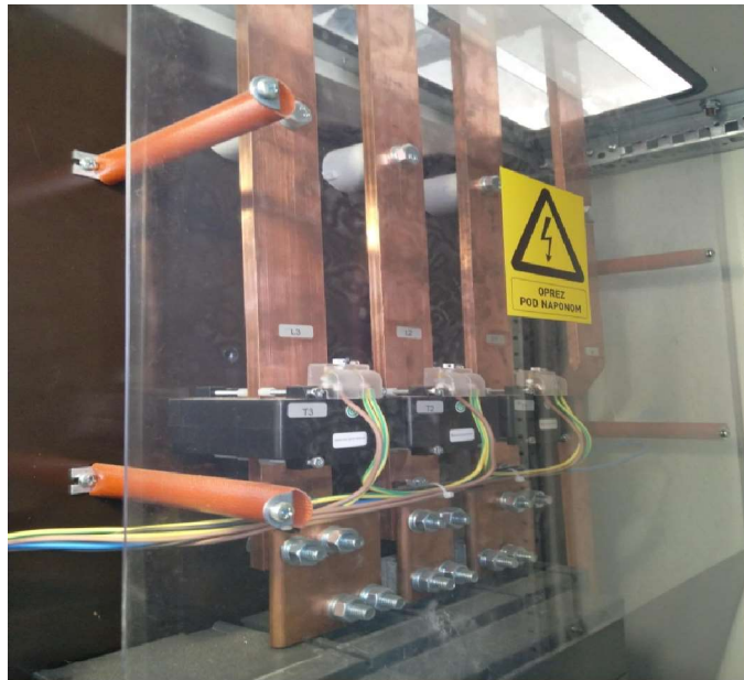
Slika 5.5. Sabirnice sa strujnim transformatorima unutar NN bloka TS Duboka [37]
