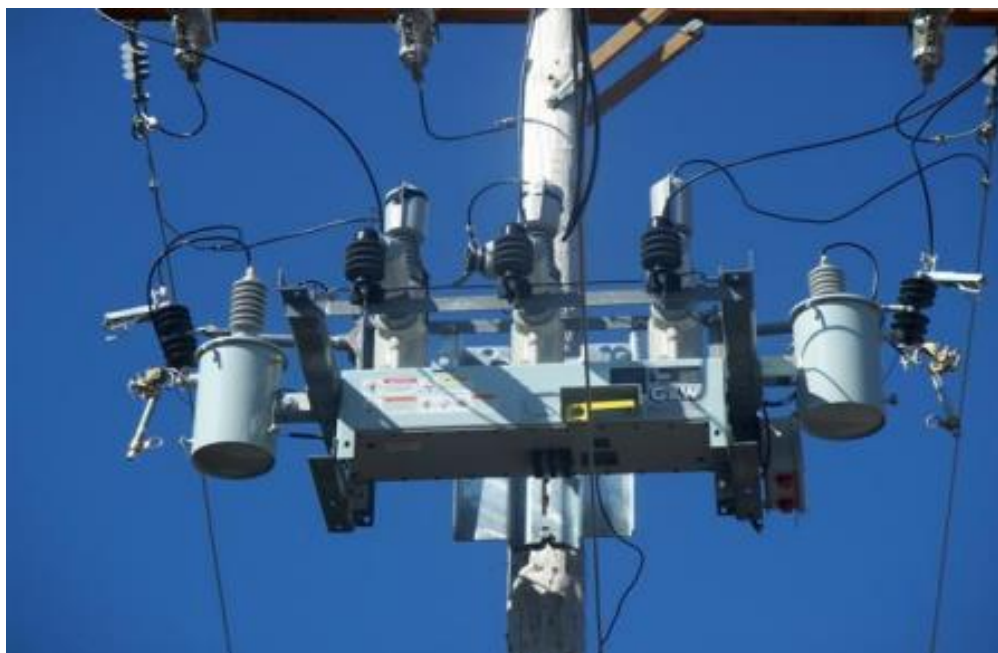
Slika 3.20. Automatski prekidač – recloser [8]
