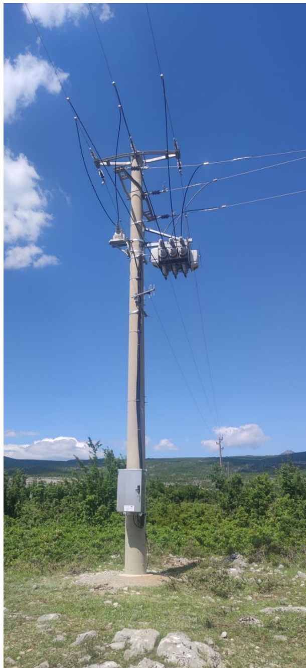
Slika 3.19. Stup sa ugrađenim DURN-om [TJ Sinj]
