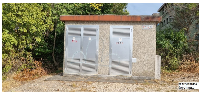
Slika 4.3.2. Trafostanica Šopot knezi
