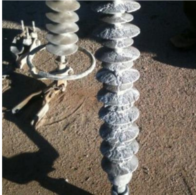
Slika 10. Naslage soli na izolatoru
