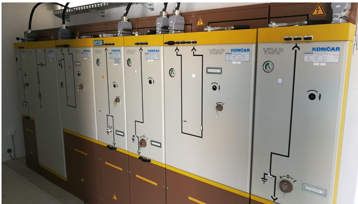
Slika 3.16. Srednjenaponski sklopni blok
