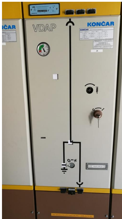
Slika 3.21. Polje kućnog transformatora
