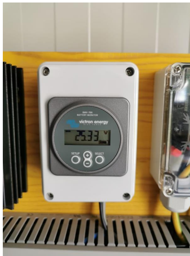
Slika 3.15 - Nadzornik baterije BMV 700
